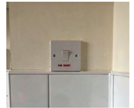
Fan boost switch
